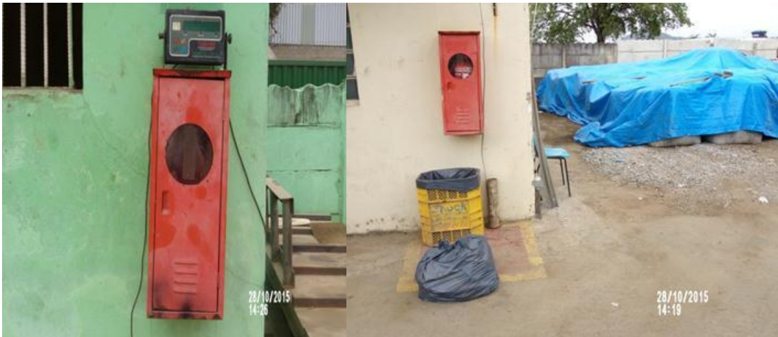
Figura 59: Falta de extintor de incêndio e objetos obstruindo o caminho até ele Fonte: Inova, 2015
