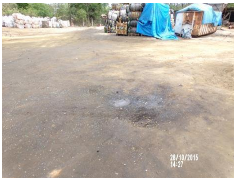
Figura 58: Presença de vários buracos no piso Fonte: Inova, 2015
