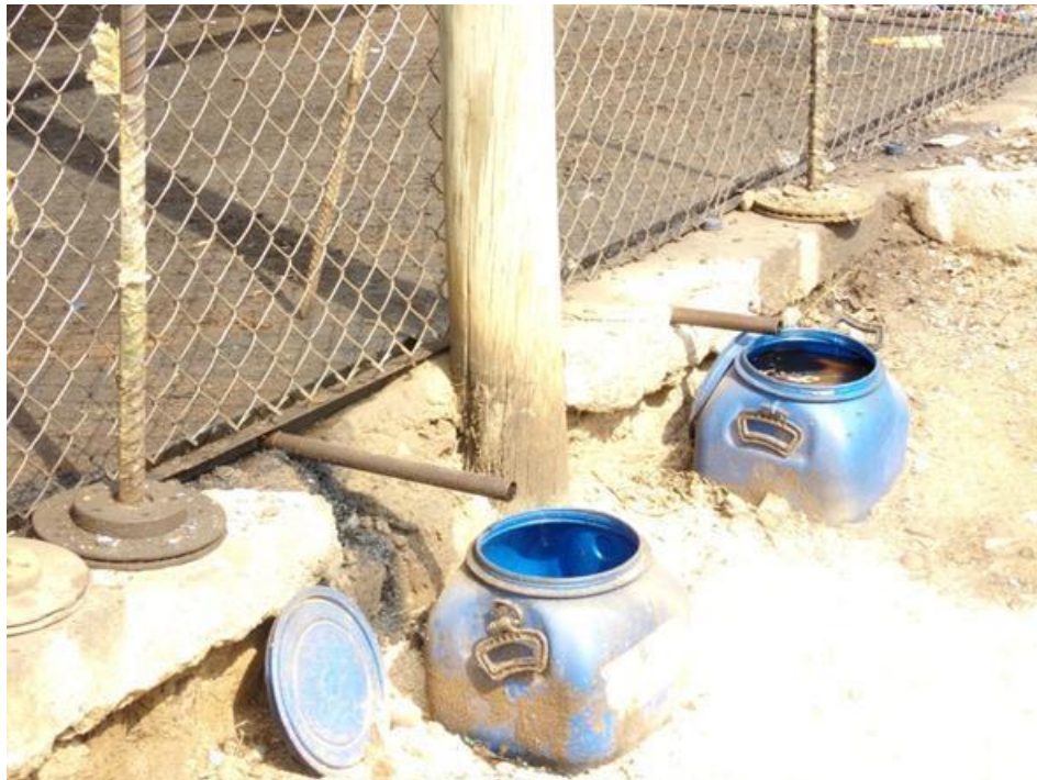
Figura 62: Tambores inadequados para recebimento do óleo da bacia de contenção Fonte: Inova, 2015
