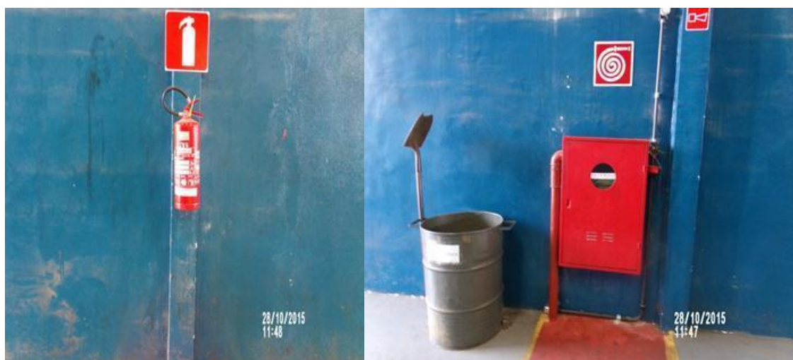
Figura 8: Sistema de incêndio da GRI-Betim Fonte: Programa Jogue Limpo, 2015
