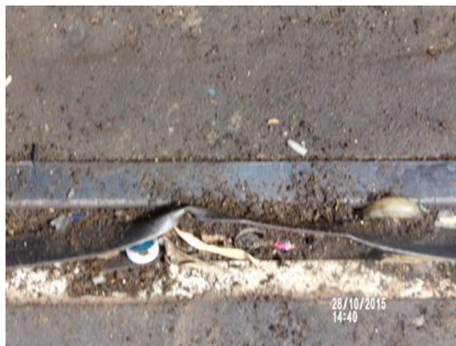
Figura 61: Canaletas estragadas na bacia de contenção Fonte: Inova, 2015
