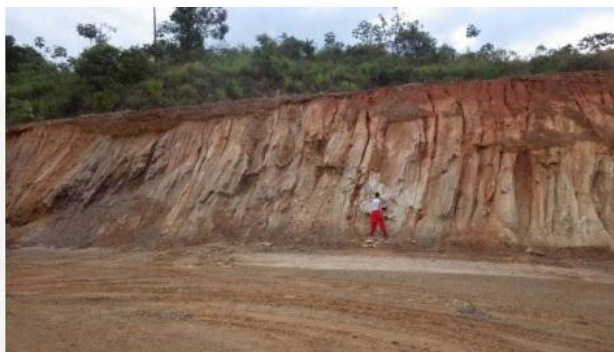
Figura 09: Afloramento de xisto, apresentando fraturas e rupturas. Fonte: EIA, 2014.
