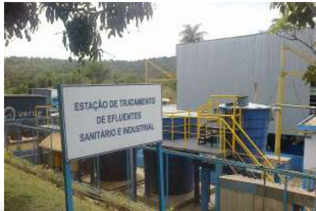
Figura 07: Estação de tratamento de efluentes sanitários do empreendimento
