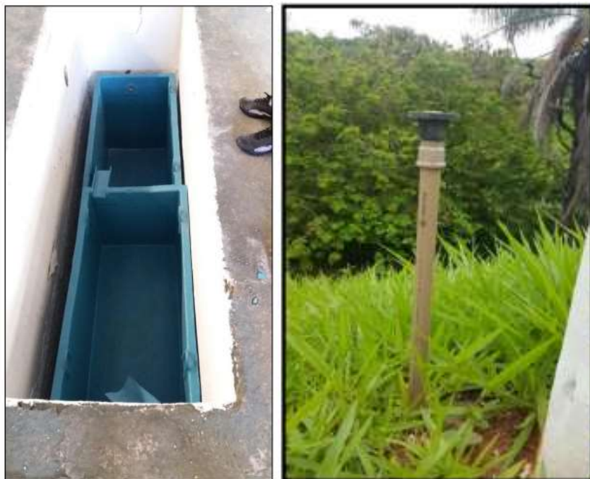
Figura 4.1.2. À esquerda caixas de decantação e à direita aspersor para irrigação com o efluente tratado do jardim e área gramada.
