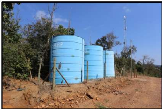
Foto 20 - Abastecimento de água do condomínio Itajurú
