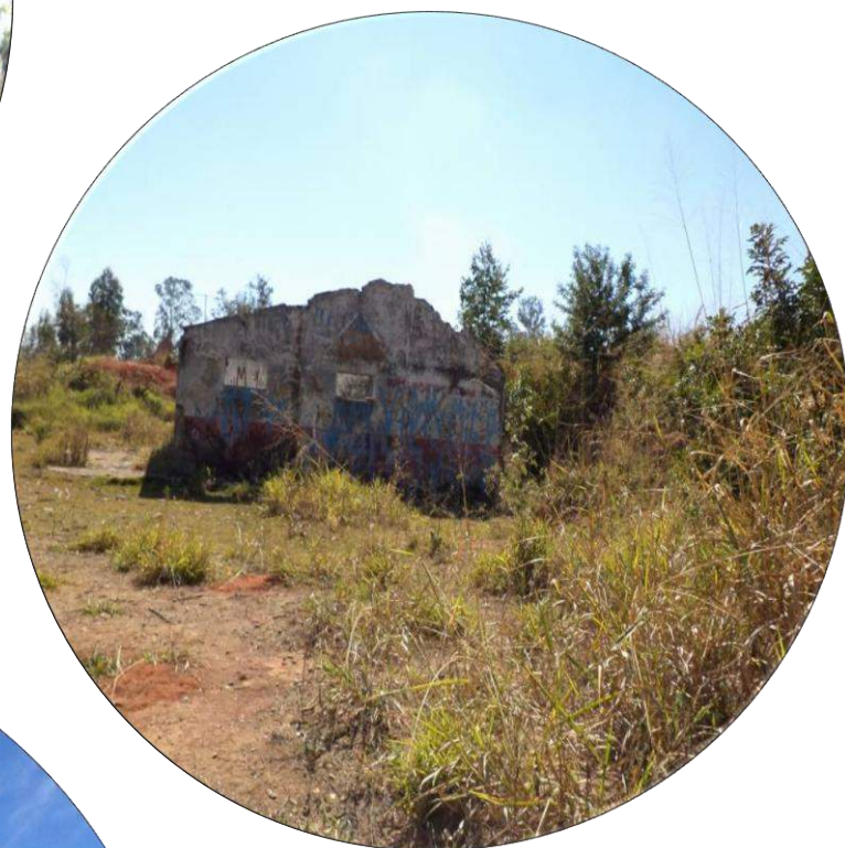
Foto 33: Área do Fragmento 1 com exposição de um vestiário degradado
