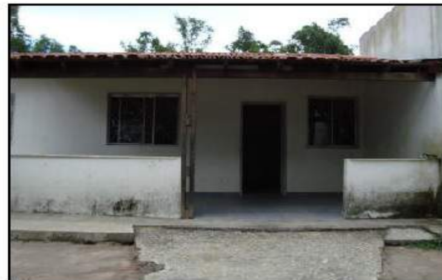
Foto Nº 07 – Vista da sede do Projeto Casa de Passagem, situado na área interna do Parque Fernão Dias.
